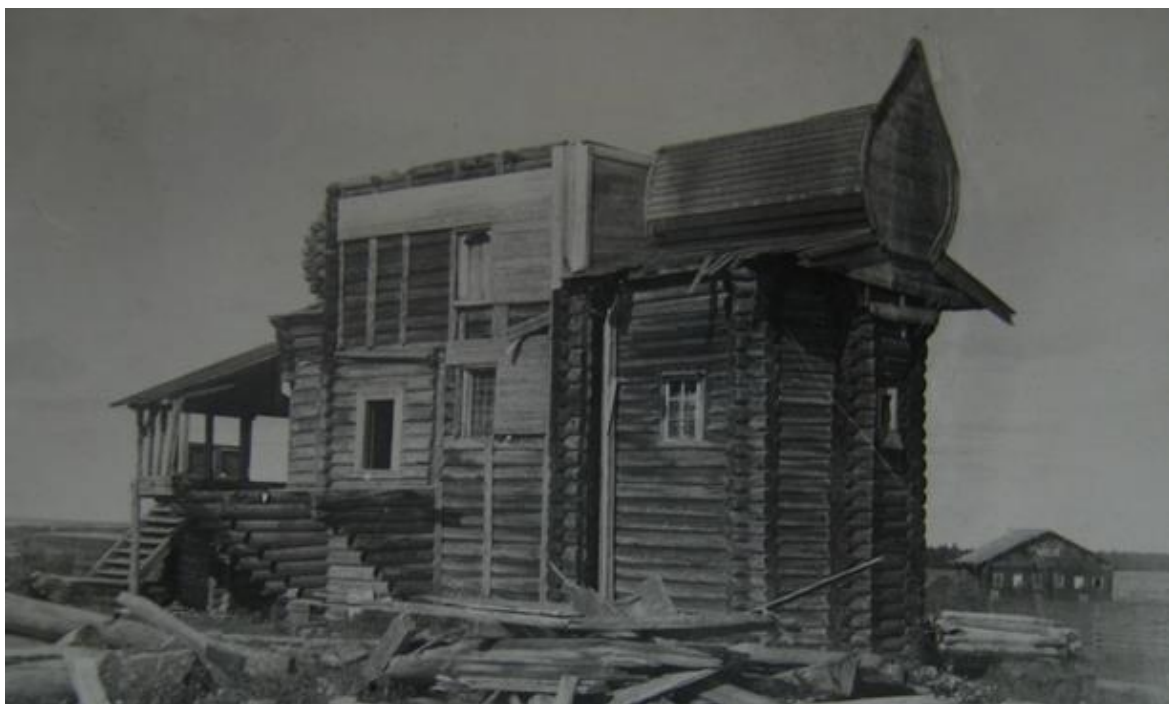
Рис. 6а. Корбала. Ильинская церковь. Разрушение. Фотоснимок 1940-х гг.
